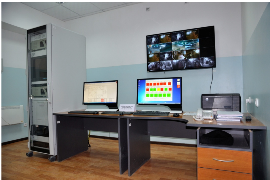
Рис. 4. Внешний вид автоматизированного рабочего места оператора интеллектуальной СМиК
